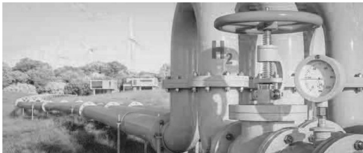
Pipeline d'hydrogène alimentant un lotissement
