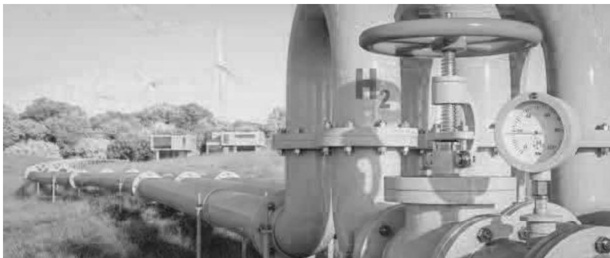
Pipeline d'hydrogène alimentant un lotissement
